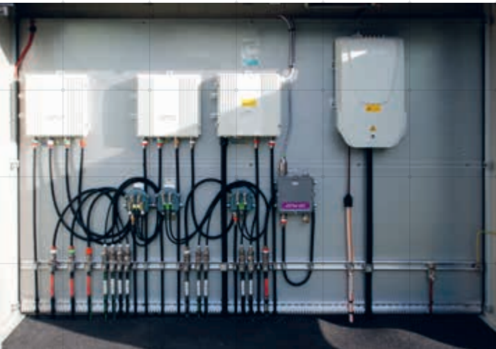
Abbildung 2: Kabine mit dem optisch-elektrischen Wandler (Node) in einem HFC-Netz
